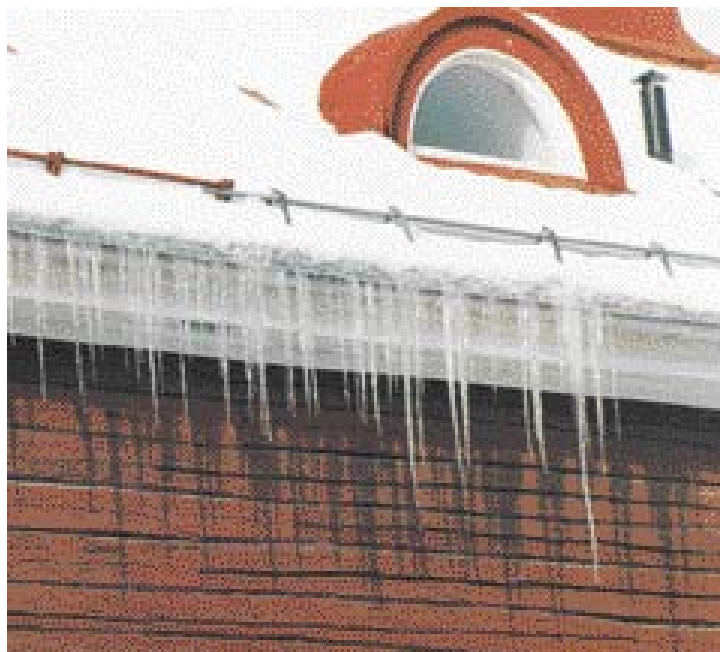
Сосульки на карнизах указывают, что тепло просачивается из дома.
